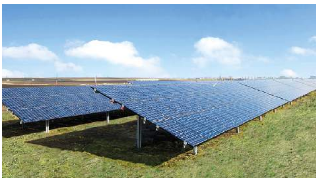
Abb. 93: Photovoltaikanlagen in Wilfleinsdorf
