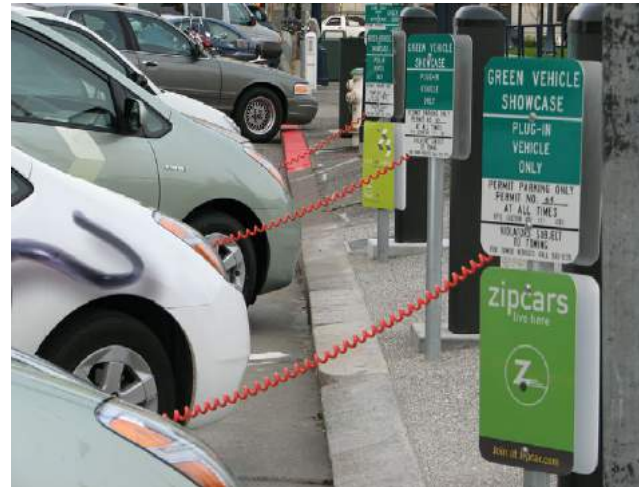
Abb. 149: Elektro Ladestation in San Francisco, USA
