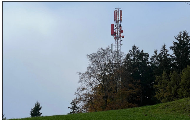
Abb. 59.1: Funkmast in der Region
